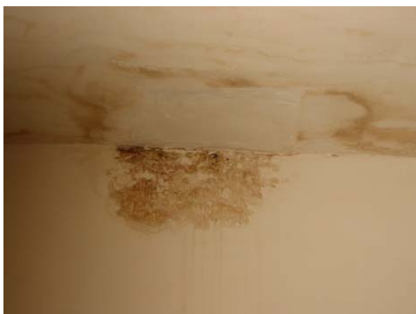
Lekken veroorzaken heel lokaal vochtproblemen (Foto VIBE vzw)
